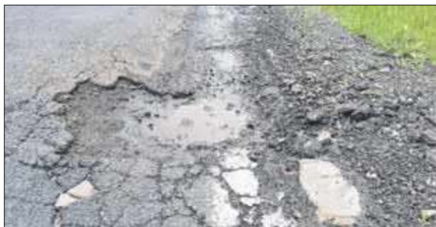
– Nawierzchnia jezdni na całym remontowanym odcinku posiada liczne spękania i nierówności zarówno o przekroju poprzecznym jak i podłużnym – mówi Kamil Jakubowski rzecznik Zarządu Dróg Wojewódzkich w Lublinie
