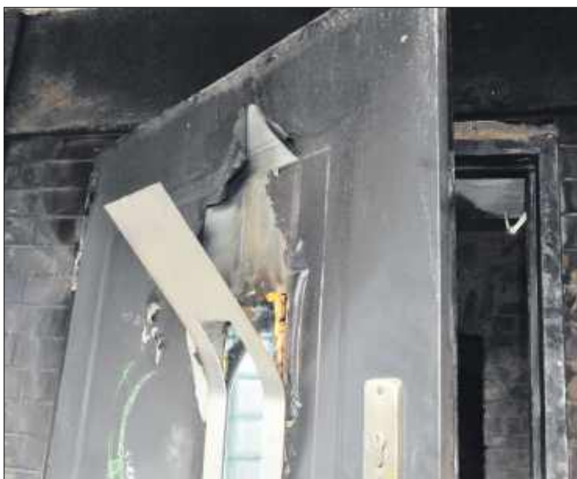
■ Uszkodzone od ognia drzwi wejściowe
