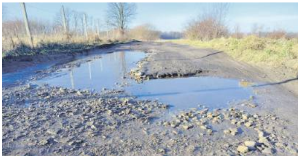
To jedno z wielu miejsc na drodze między Wyszonicami a Krzepicami, na którym asfaltowa nawierzchnia została całkowicie zniszczona
