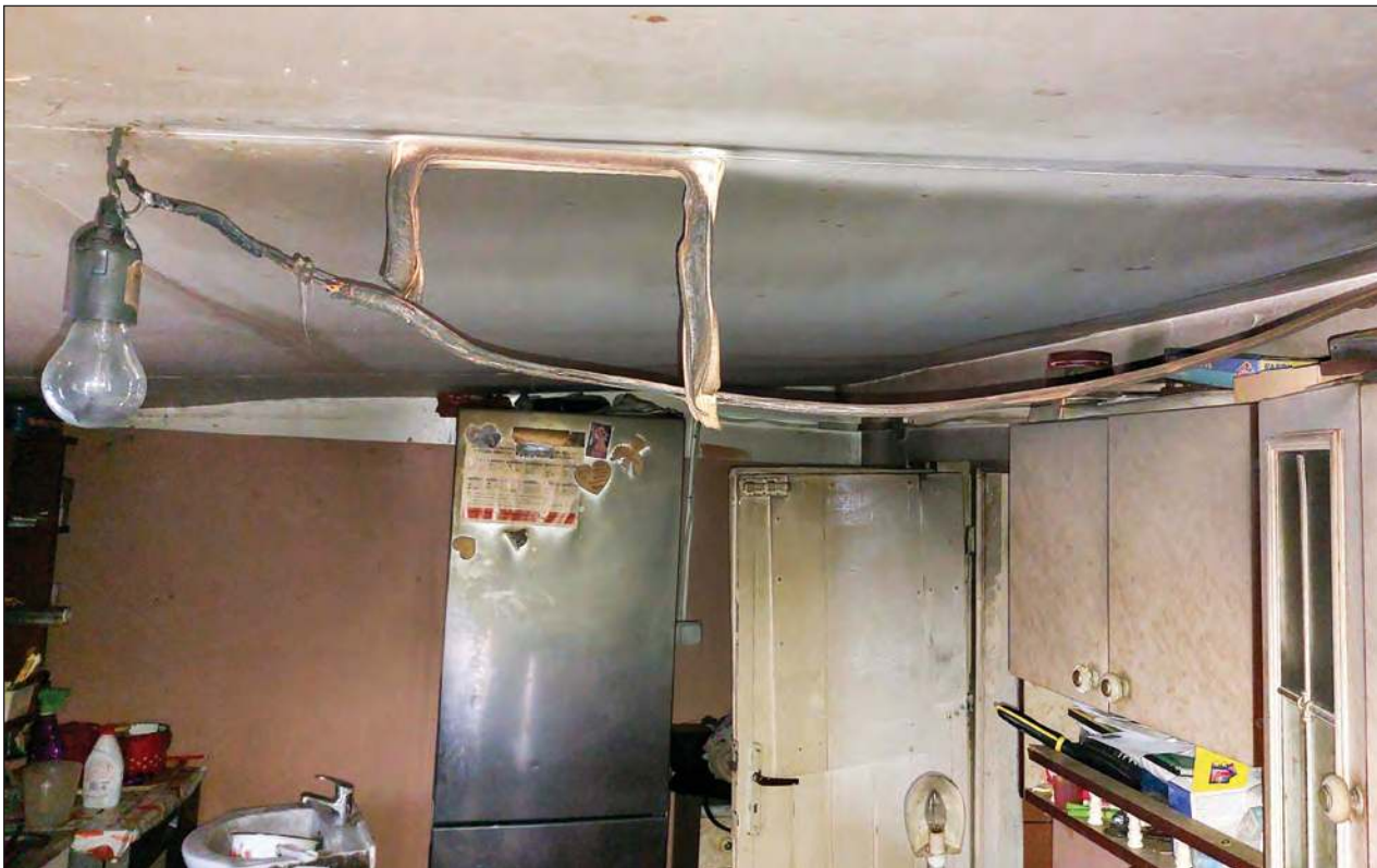
» W kuchni stopiło kable oraz osmałiło ściany i sprzęt. Cały czas czuć swąd spalenizny
