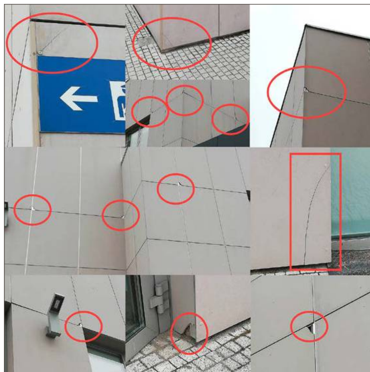
Stan dworca w siedem lat po przebudowie pozostawia wiele do życzenia.
