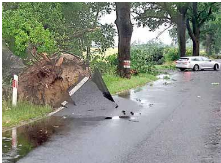
W Dolicach wyrwane drzewo uszkodziło asfalt. Foto. OSP. Dolice
