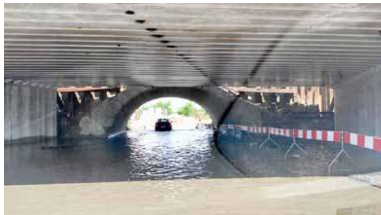
Woda była na całej powierzchni przejazdu i przejścia pod wiaduktem
