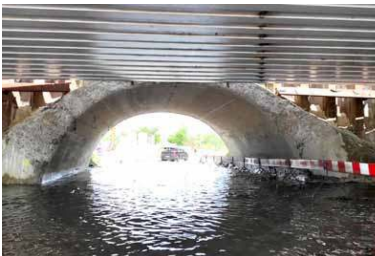
Wiadukt na ul. Składowej. Tak mocno zalany wodą był jeszcze w poniedziałek przed południem
