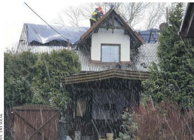
Po pożarze strażacy pomogli zabezpieczyć spalony dach
