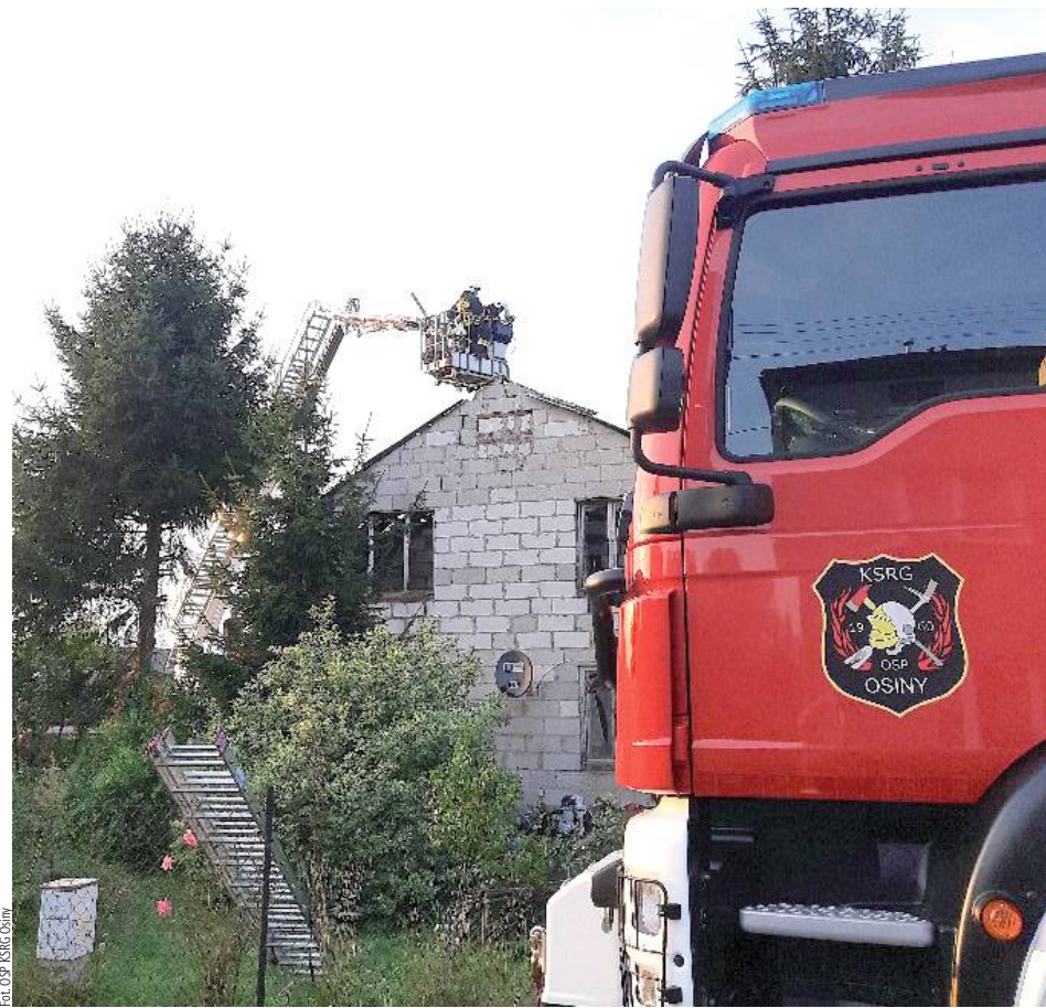
Kilka dni po pożarze strażacy zabezpieczyli uszkodzony dach budynku
