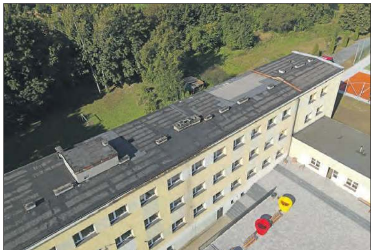
Dach raclawickiej szkoły zajmuje potężny obszar. W kilku miejscach przecieka, a woda zalewa klasy. W tych klasach od kilku lat nie można prowadzić zajęć.
