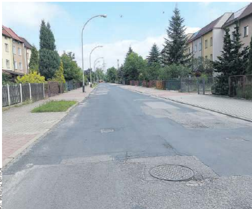
Ulica Wańkowicza, na remont której mieszkańcy osiedla Hutnik czekają od lat
