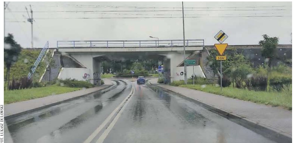
Wiadukt kolejowy nad ul. Sikorskiego w Chrzanowie nadaje się do remontu
