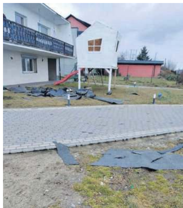
W Przewornie na ul. Ziembickiej zerwane zostało poszycie dachowe (papa) z połowy budynku. Foto: Strzelin998
