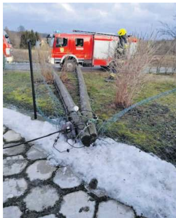
Ten słup energetyczny przewrócił się do ogrodu w Dobroszowie. Foto: Strzelin998
