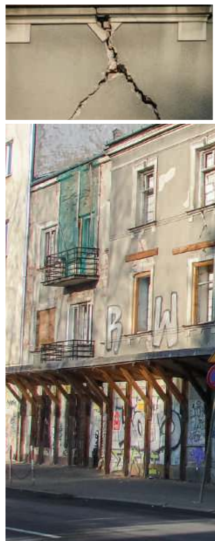
Kamieniczka przy ul. Chełmskiej 36 oraz pęknięcia na
