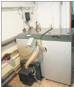
Na terenie gminy zamontowano 8 kotłów na biomasę
