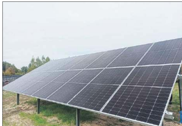
Na terenie gminy zamontowano m.in. 78 instalacji fotowoltaicznych o mocach 1,9 kW, 3,42 kW lub 4,56 kW
