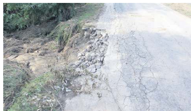
To zniszczenia po ostatniej nawałnicy na drodze w Sulimowie.
