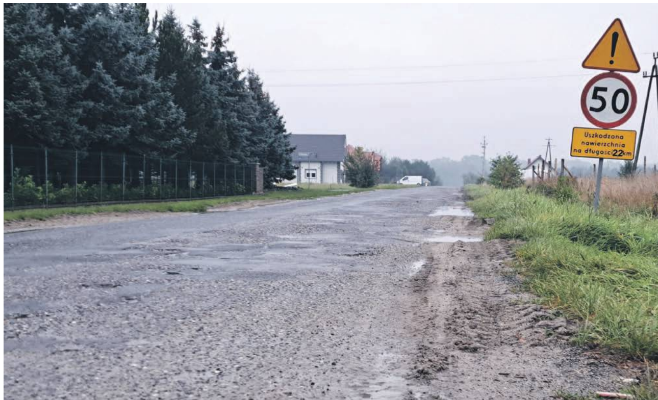
Na remont tej drogi, z Bystrzycy do Minkowic Oławskich, czekamy od lat
