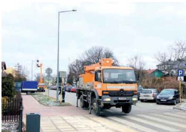
W gminie Opole Lubelskie wymienionych zostanie 2300 opraw oświetleniowych. Sodowe zastąpią nowe ledowe. Pojawić ma się też dziewięć nowo zaprojektowanych obwodów oświetlenia ulicznego
