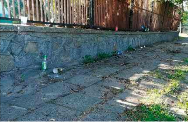
Remont prawdopodobnie będzie się wiązał z wycięciem okolicznych topoli, których korzenie rozsadzają chodnik i ogrodzenie obiektów MOSiR
