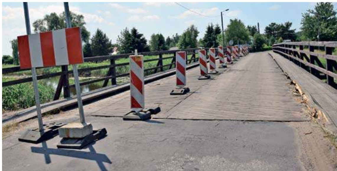
Nowy most ma zastąpić lichą drewnianą konstrukcję (fot. powiat nowosolski)
