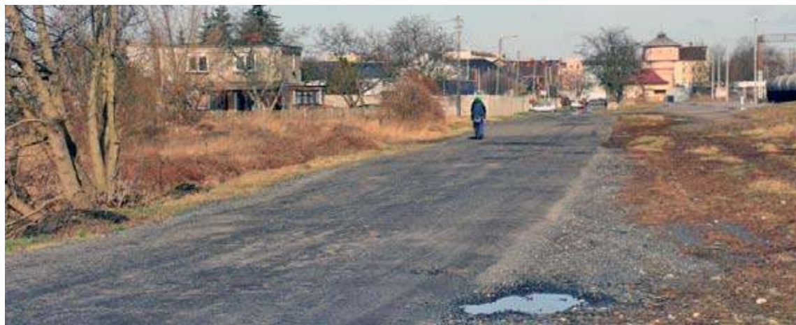
Dziś ul. Długa pozostawia wiele do życzenia (fot. UM Nowa Sól)
