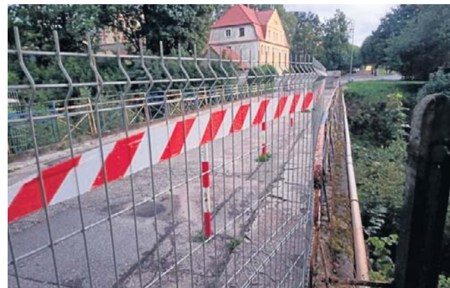
Według szacunków zburzenie starego i budowa nowego wiaduktu to koszt 7-9 milionów złotych
