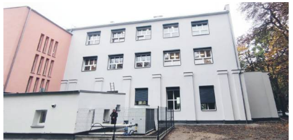
Budynek strzelińskiego technikum został wyposażony w nowoczesną pompę ciepła, widoczną na pierwszym planie
