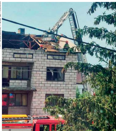
W Chamsku wiatr zerwał dach z budynku jednorodzinnej. Pokrycie uderzyło w inny budynek mieszkalny...
