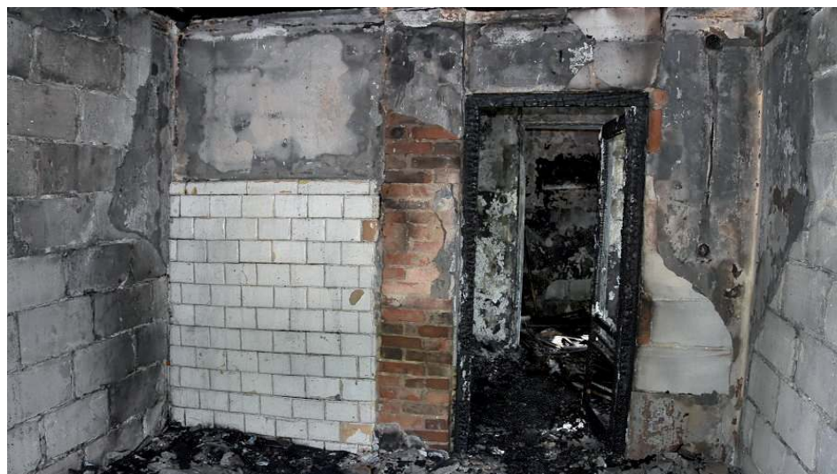
Skutki podpalenia niezamieszkałego domu
