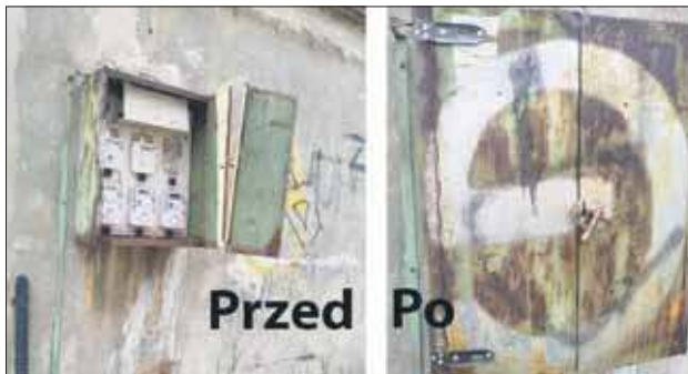
Skrzynka została natychmiast zabezpieczona
