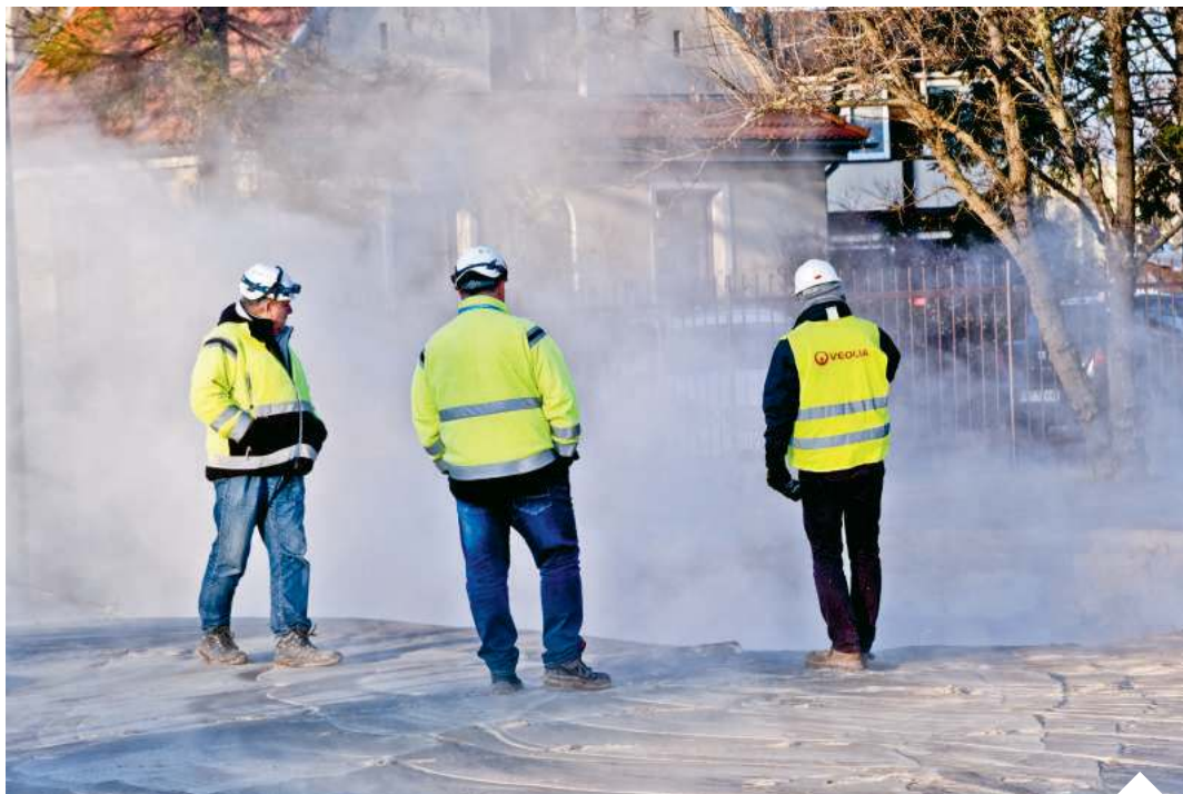
Przy ul. Powiśńskiej uszkodzeniu uległa rura ciepłownicza z gorącą wodą, z której nastąpił wyciek | fot. Filip Błażejowski/Gazeta Polska
