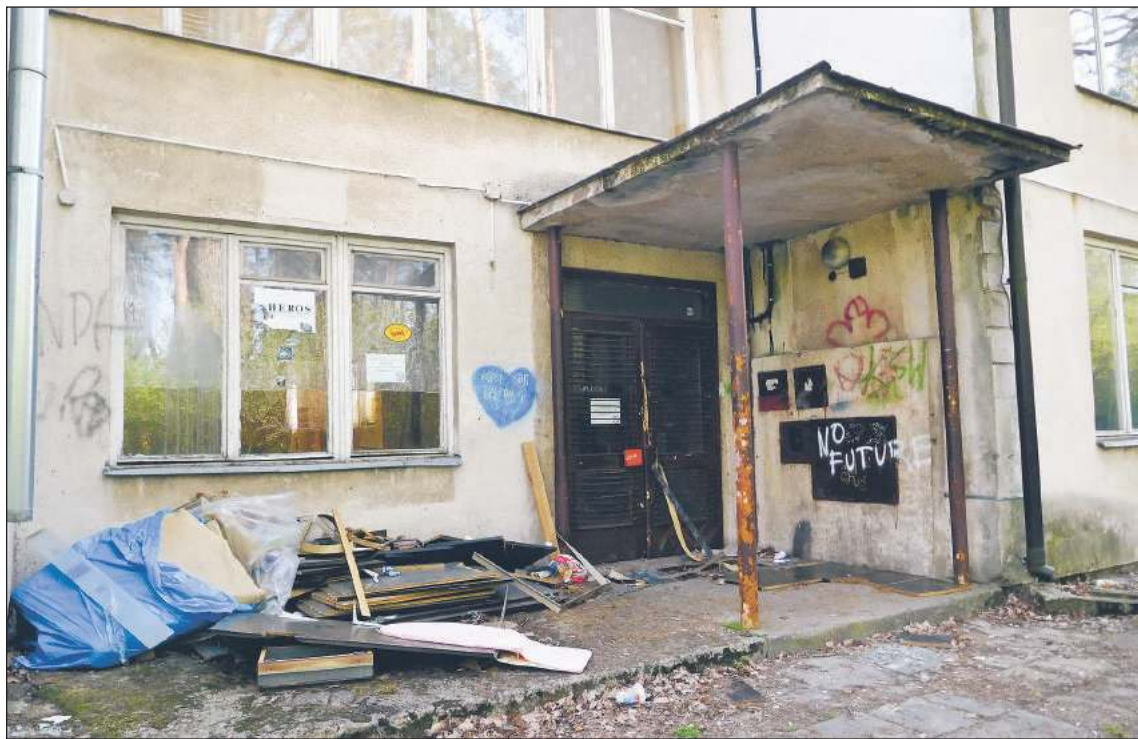
Budynek dawnego internatu, w którym do niedawna mieszkało siedem rodzin, wymaga kapitalnego remontu.
