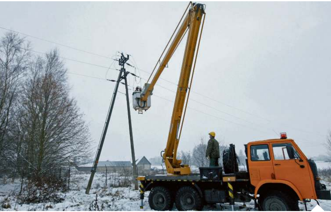
Wciąż trwają naprawy uszkodzeń sieci elektrycznych | fot. Artur Reszko/PAP
