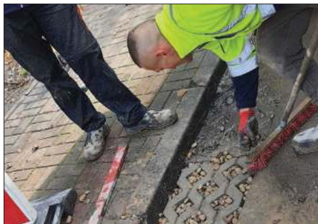
■ Po pierwszych opadach deszczu przy jednym z bloków okazało się, że wykonane odwodnienie wymaga drobnej modyfikacji
