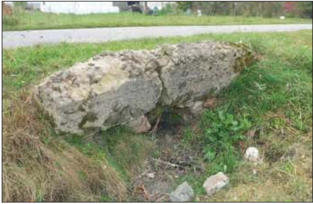
Niepokój gospodarza wsi budzi również przepust przy drodze. Jest nie tylko pęknięty, ale i do połowy zamulony
