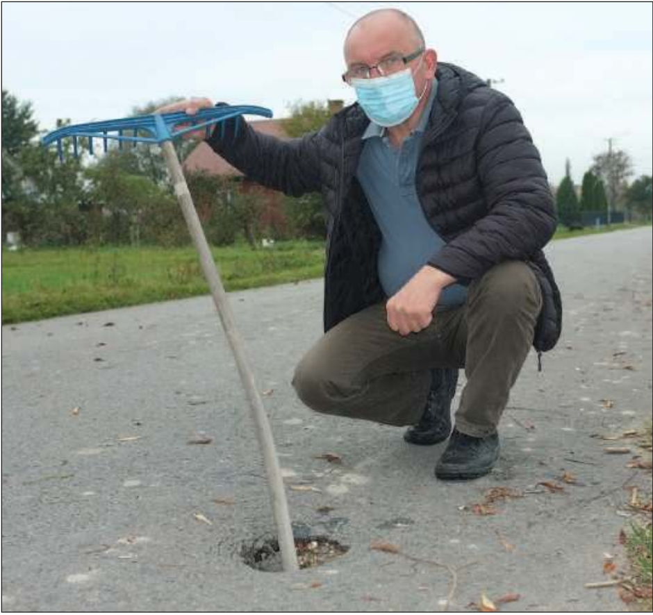
Sołtys Kalinowa Andrzej Domaszczyński uważa, że znajdująca się na jezdni zapadlina może z czasem doprowadzić do nieszczęścia
