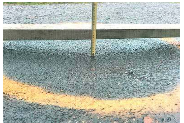
W niektórych miejscach dziury sięgają nawet 13 cm głębokości
