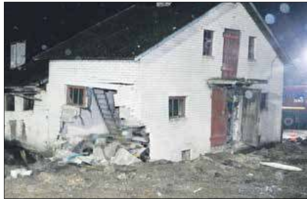
Podczas remontu obory doszło do zawalenia się jednej ze ścian nośnych budynku
