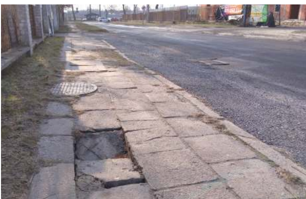
Pamiętką po dawnym województwie białkopodlaskim są pozostałości kanalizacji burzowej z wlotem koniecznym powyżej powierzchni chodnika. Woda rozlewa się poniżej i wypłukuje piasek pod płytkami, które załamują się i tworzą pułapki na przechodniów. Dzieło białkopodlaskiej sztuki inżynierskiej na ul. Kąpielowej
