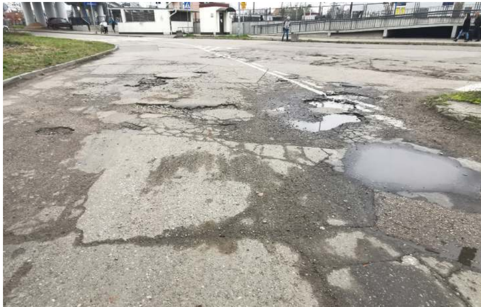
Dziurawa droga, w końcu doczeka się remontu
