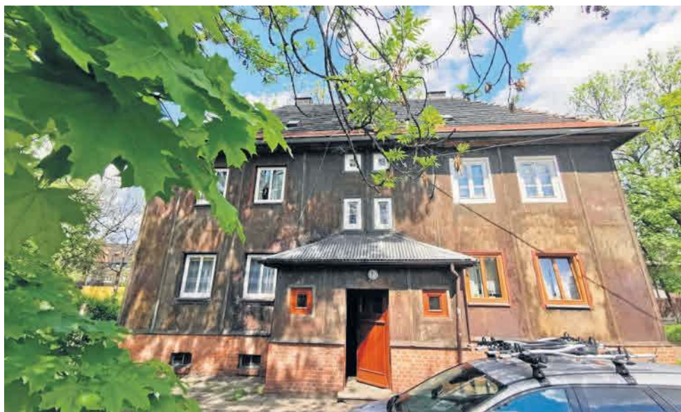
- Proszę zwrócić uwagę na te ściany - pokazuje Dariusz Walerjański. - To nie odchodzi farba, to jest rdza! Rdza na stalowej ścianie
