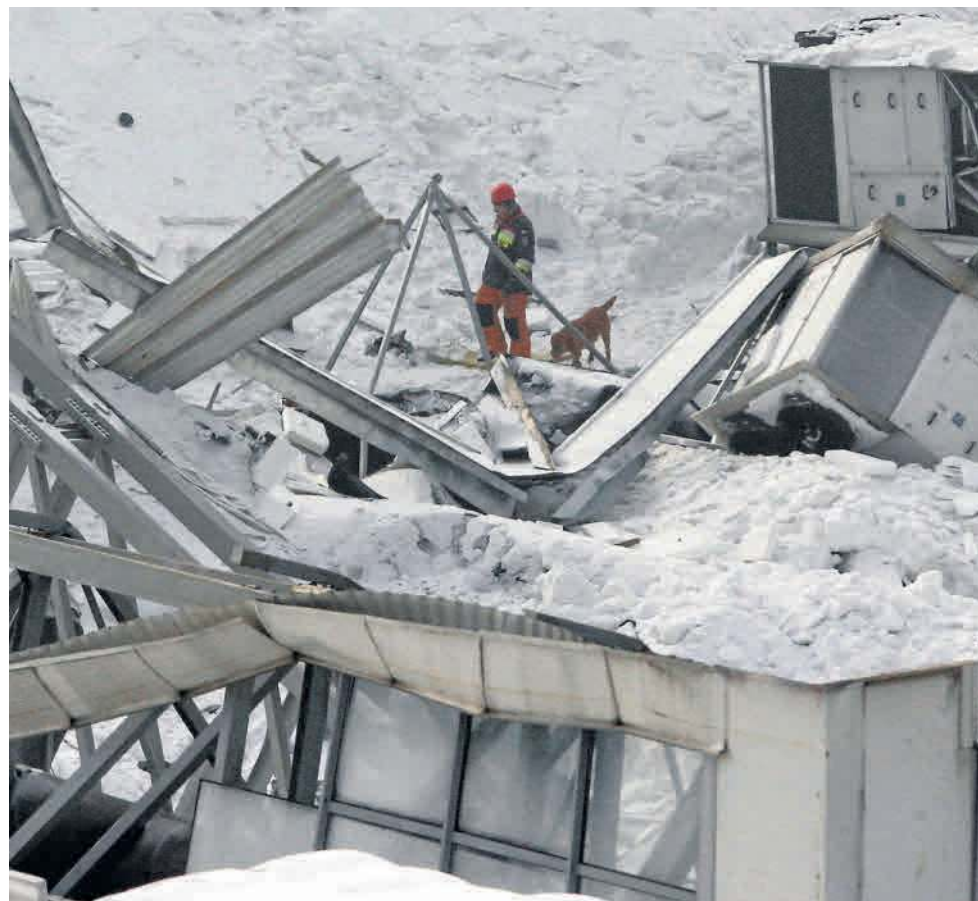
Do zawalenia się dachu hali doszło 28 stycznia 2006 podczas wystawy gołębi pocztowych
