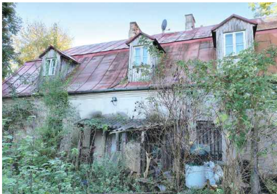
Przed oczyszczaniem kamieniczka wyglądała na bardzo zaniedbaną
