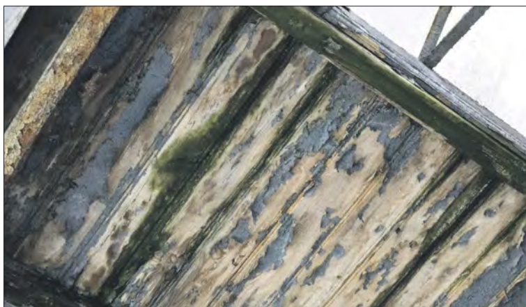
Butwiejąca konstrukcja wiaty to nie tylko zaniedbanie, ale również i granie z bezpieczeństwem podróżnych
