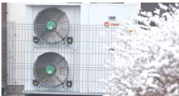
W Leopoldowie zastosowano pompy ciepła powietrze-woda, które stanowią będą podstawowe źródło ciepła budynku głównego Domu Pomocy Społecznej oraz Ośrodka Wsparcia w Leopoldowie
