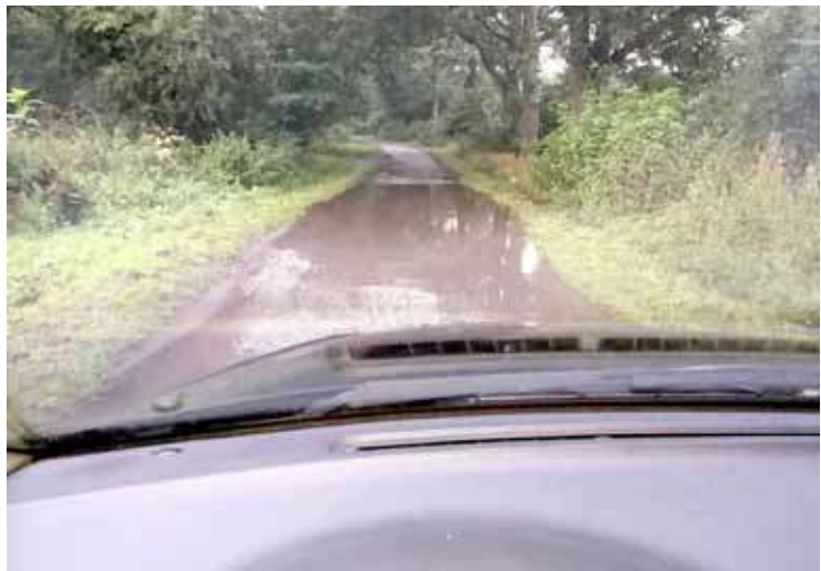
Po opadach deszczu, z powodu wielkich dziur, powstają ogromne kałuże
