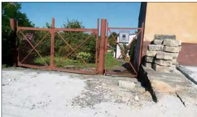
Tak wygląda po „modernizacji” dojście do domu nr 64. Trudno to uznać za polepszenie.
