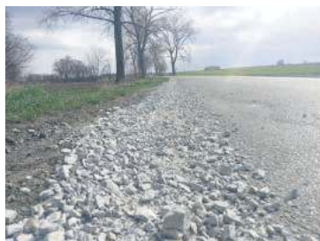
Główną przyczyną złego stanu drogi jest transport kruszywa ciężkimi pojazdami z pobliskiej kopalni
