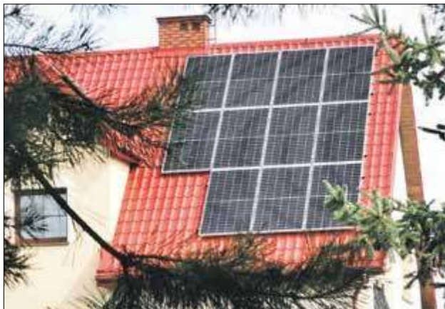
Firma montuje instalacje elektryczne i fotowoltaiczne dla domu, rolnictwa i przemysłu
