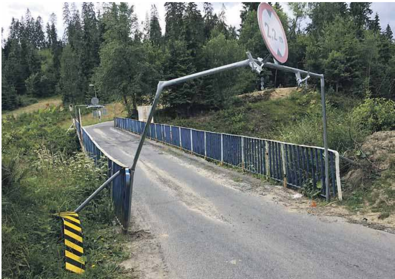
Zniszczone oznakowanie na wiadukcie w Pyzówce.
