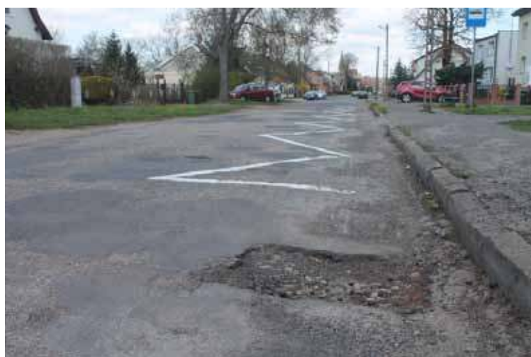
A to już widok na ulicy Nowowiejskiej. Ogromna dziura tuż przy krawężniku
