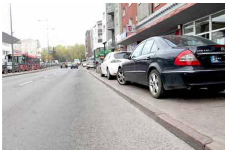
Zdaniem mieszkańców, a zwłaszcza stargardzkich kierowców, krawężnik na ul. Wyszyńskiego jest zbyt wysoki, przez co uszkodzane są opony i felgi
