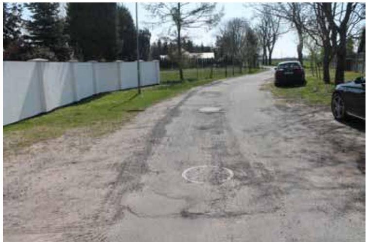
Na Sikorskiego zapadnięta jest jezdnia w miejscu robót związanych z przebudową kanalizacji sanitarnej i przy niewielkich opadach stoją kałuże wody na odcinku ok. 15 m
