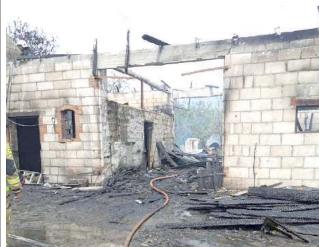
Pożar budynków w Kamionce. Strażacy ugasili ogień i ewakuowali zwierzęta
