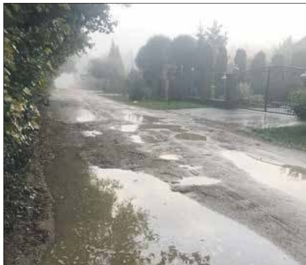
Tak po deszczu wygląda gminna droga Sitnik – Rakowiska. Samorządowe władze twierdzą jednak, że nie jest ona jeszcze w tak złym stanie jak pozostałe
