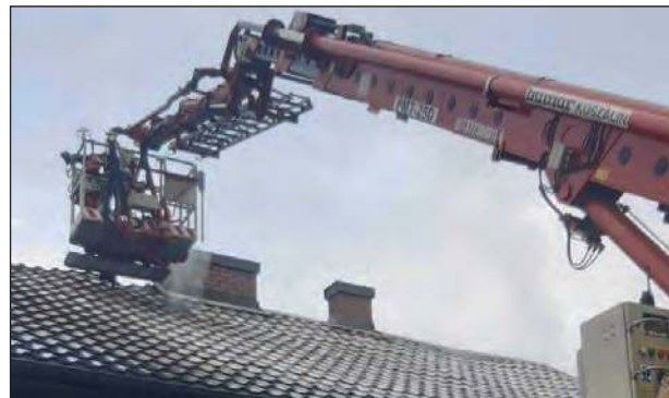
Nadzór budowlany co prawda dopuścił budynek do generalnego remontu. Jednak zakres prac do wykonania jest ogromny
