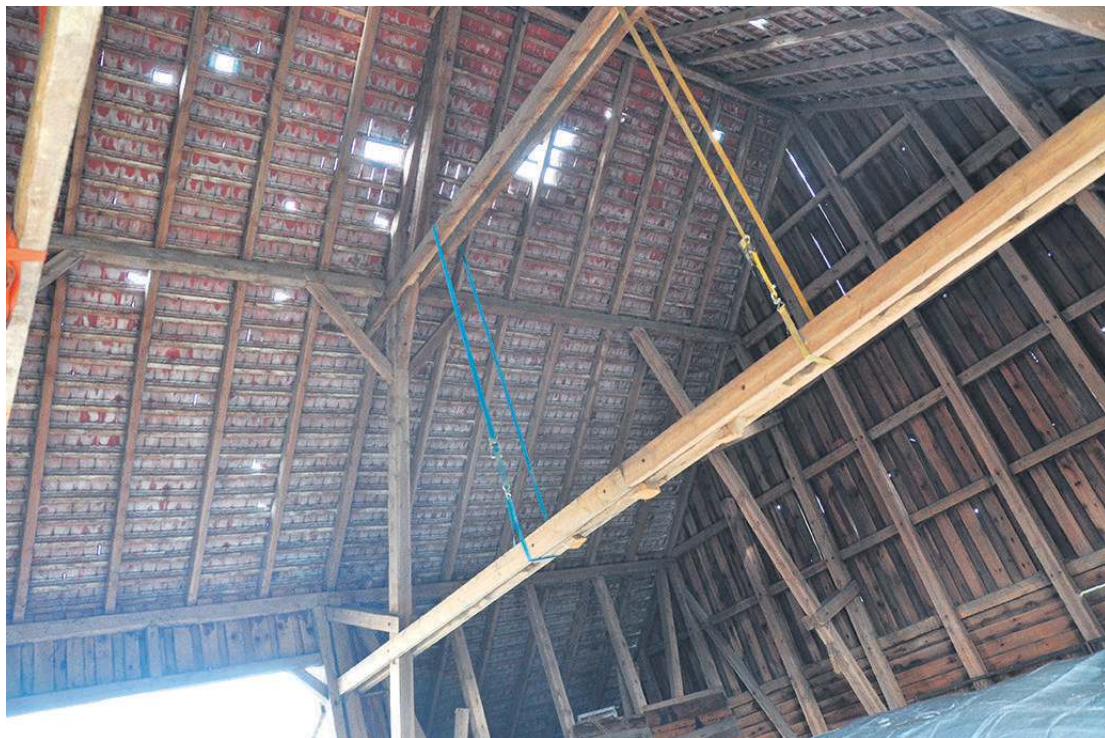
Wichura pozrywała z dachu stodoły część dachówek. Przez prześwity lała się woda, niszcząc zgromadzone plony.
