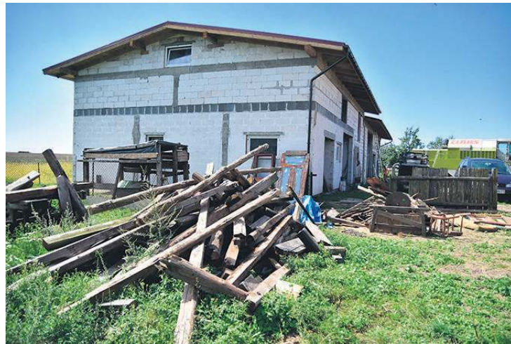
Obejście wciąż przypomina o nawałnicy. Żywiół poważnie uszkodził mienie rodziny. W szybkiej odbudowie nie pomógł fakt, że zostali oszukani przez firmę budowlaną.
