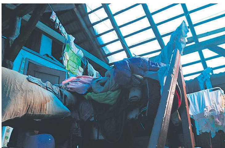
Stan dachu domu Gołębiowskich w sierpniu ubiegłego roku. Widok z poddasza w niebo. Zamiast dachu – plandeki. Fot. Jarosław Kania
