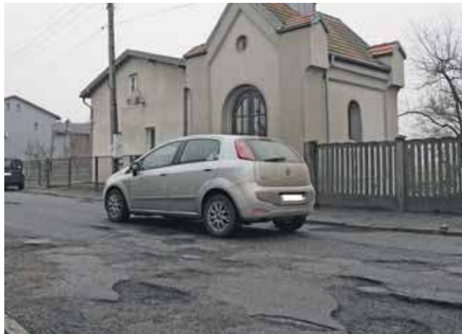
Po naszej interwencji, w ubiegłym tygodniu, asfalt w tym miejscu został sfrezowany
