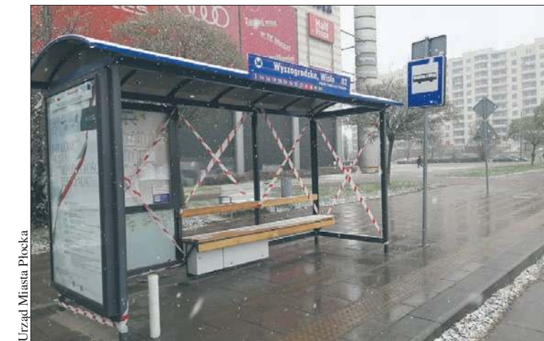
Uszkodzona przez wandalę wiatra przystankowa przy al. Jana Pawła II
