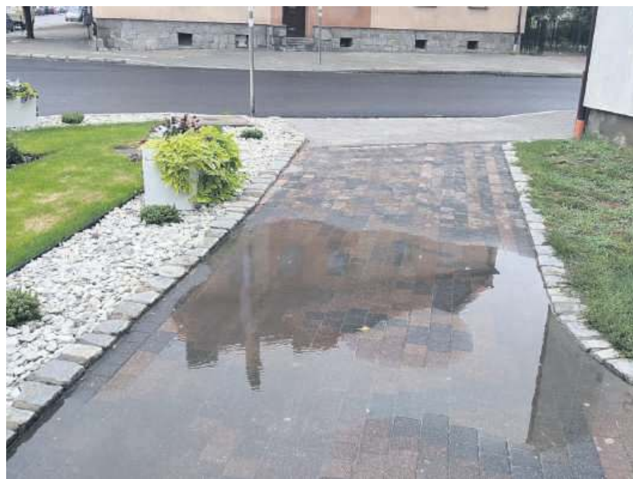
Remont wypłoszył kałuże z jezdni, to znalazły sobie miejsce na chodniku
