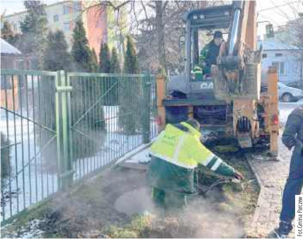
Pracownicy ZUK Parczew usuwają awarię
